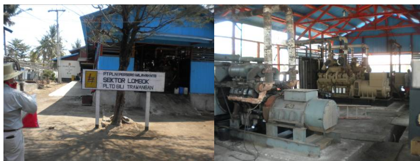
図 3.1.3-2 Gili Trawangan 島のディーゼル発電所外観
