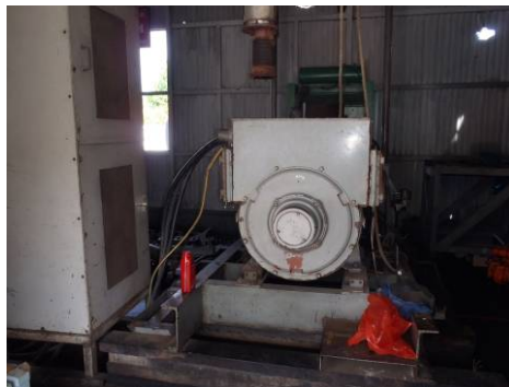
図 3.1.2-2 Bunaken 島のディーゼル発電所の外観図（発電機と制御盤）
