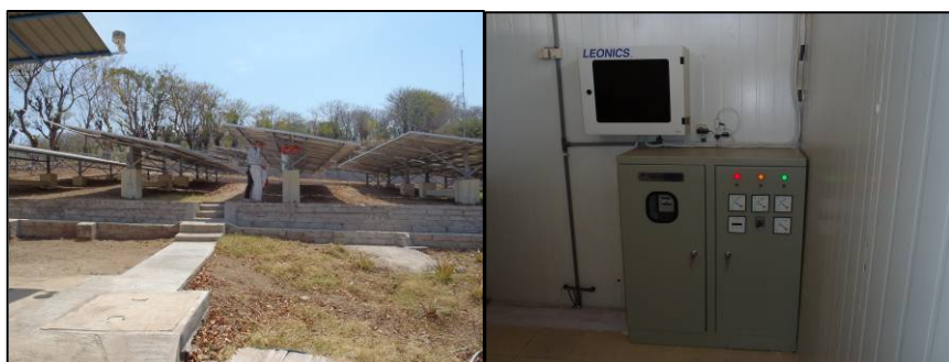
図 3.1.3-3 Gili Trawangan 島の太陽光発電所外観
