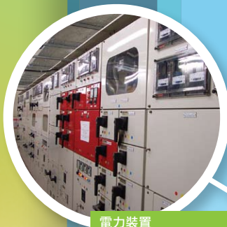
電力裝置 Electrical installation
